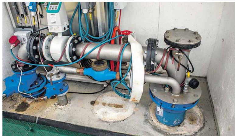
Det nederste vandrette rør forsyner Gjerndrup med drikkevand fra boringen til højre. Det tykke, vandrette rør ovenover forsyner DIN Forsyning.
